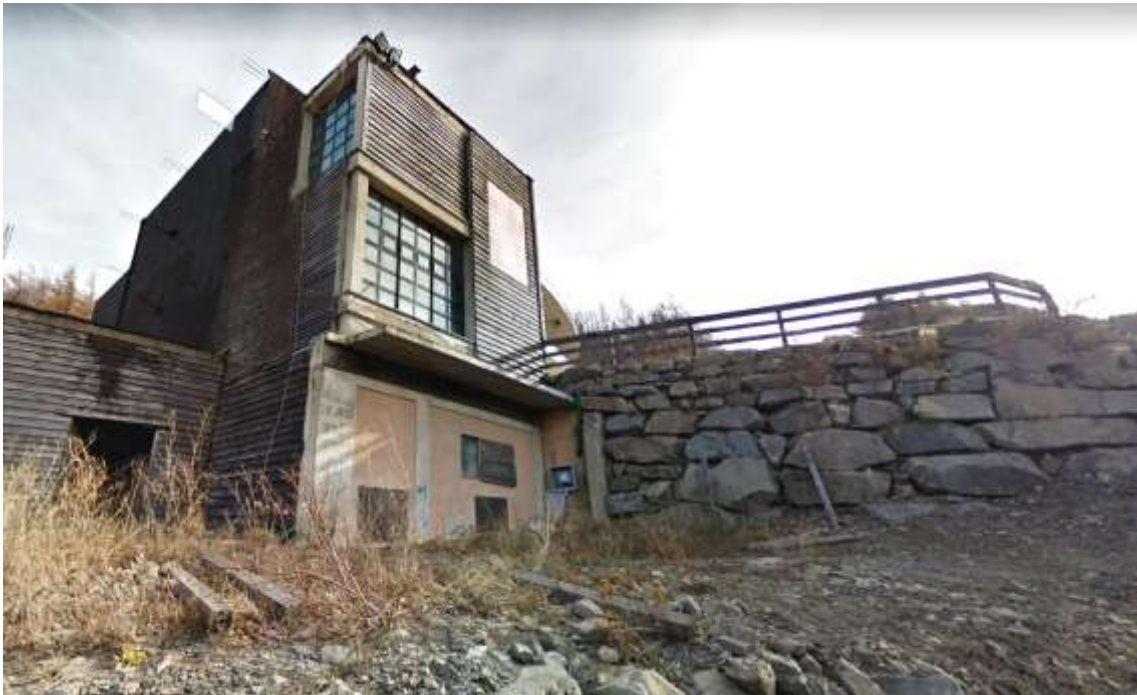
Figura 56 – Edificio ricettivo in stato di abbandono denominato "Tana della Cavalla" (web)
